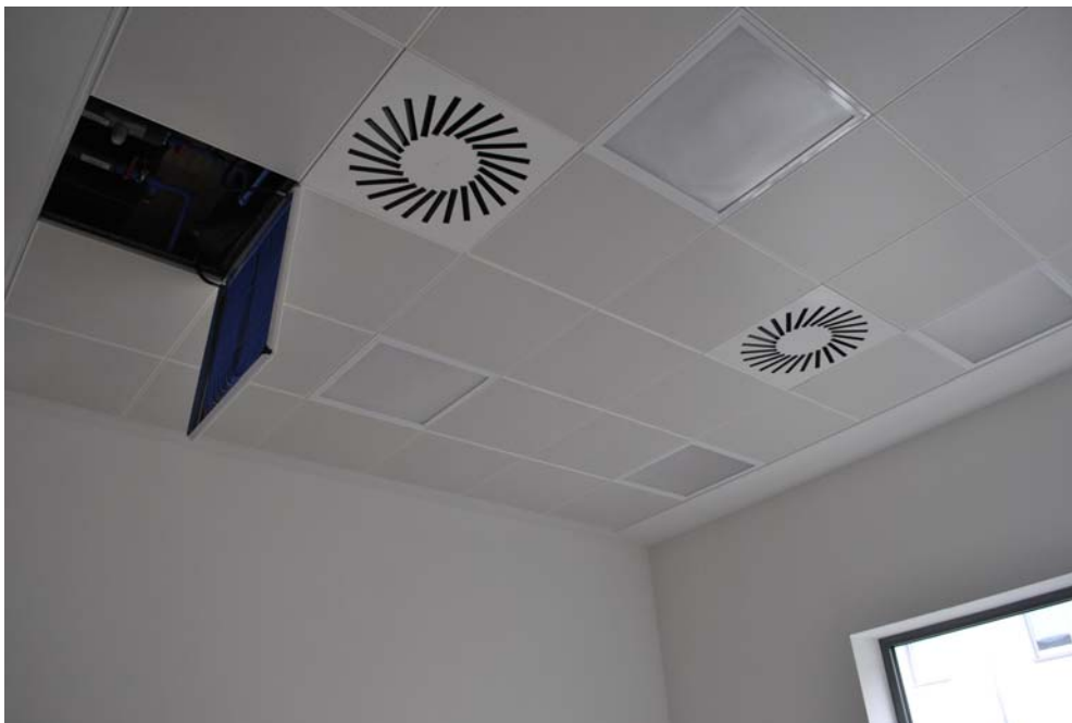
Luftauslässe, daneben geklapptes Kühldeckenelement
