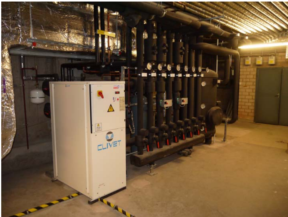
Kälteerzeuger mit Kälteverteiler
