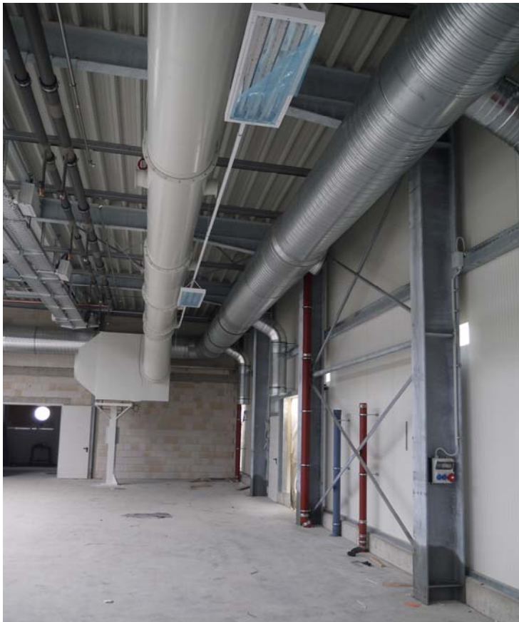
Luftleitung und Auslässe
