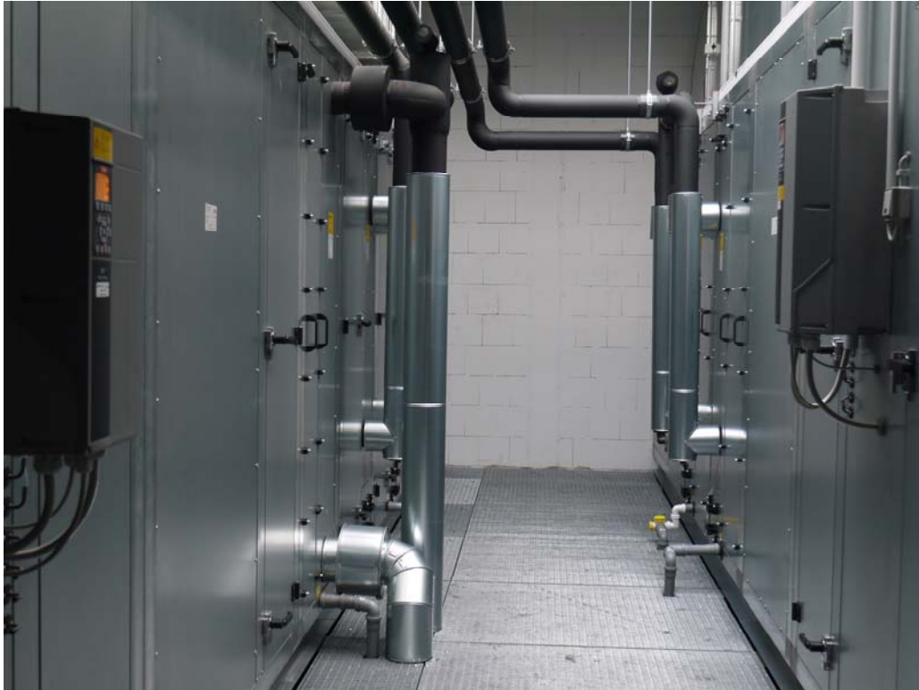
Blick in die RLT-Zentrale
