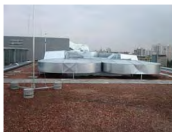
Blick auf Lüftungszentrale Dach
