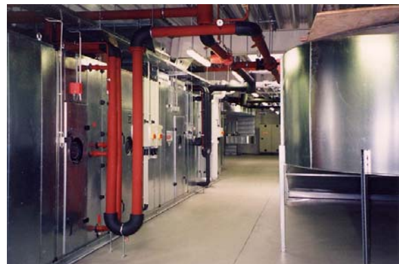
Lüftungszentrale Rollwerk / Presswerk
