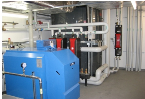
Kesselanlage mit Speicher und Modulen
