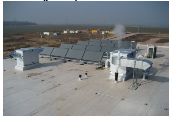
Solar- und Lüftungsanlagen auf Dach
