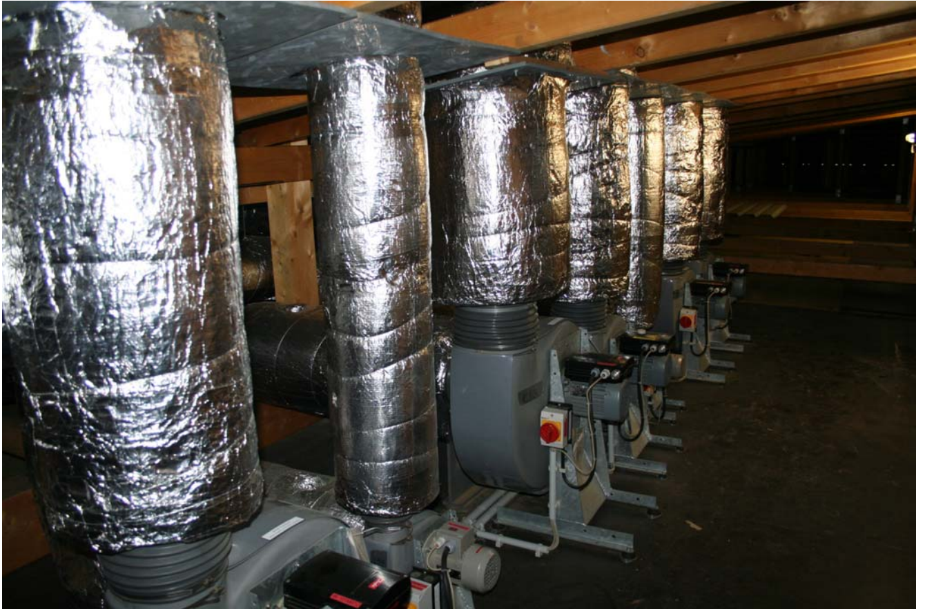
Frequenzumformer-gesteuerte Abluftventilatoren für Digestorien und Sicherheitschränke
