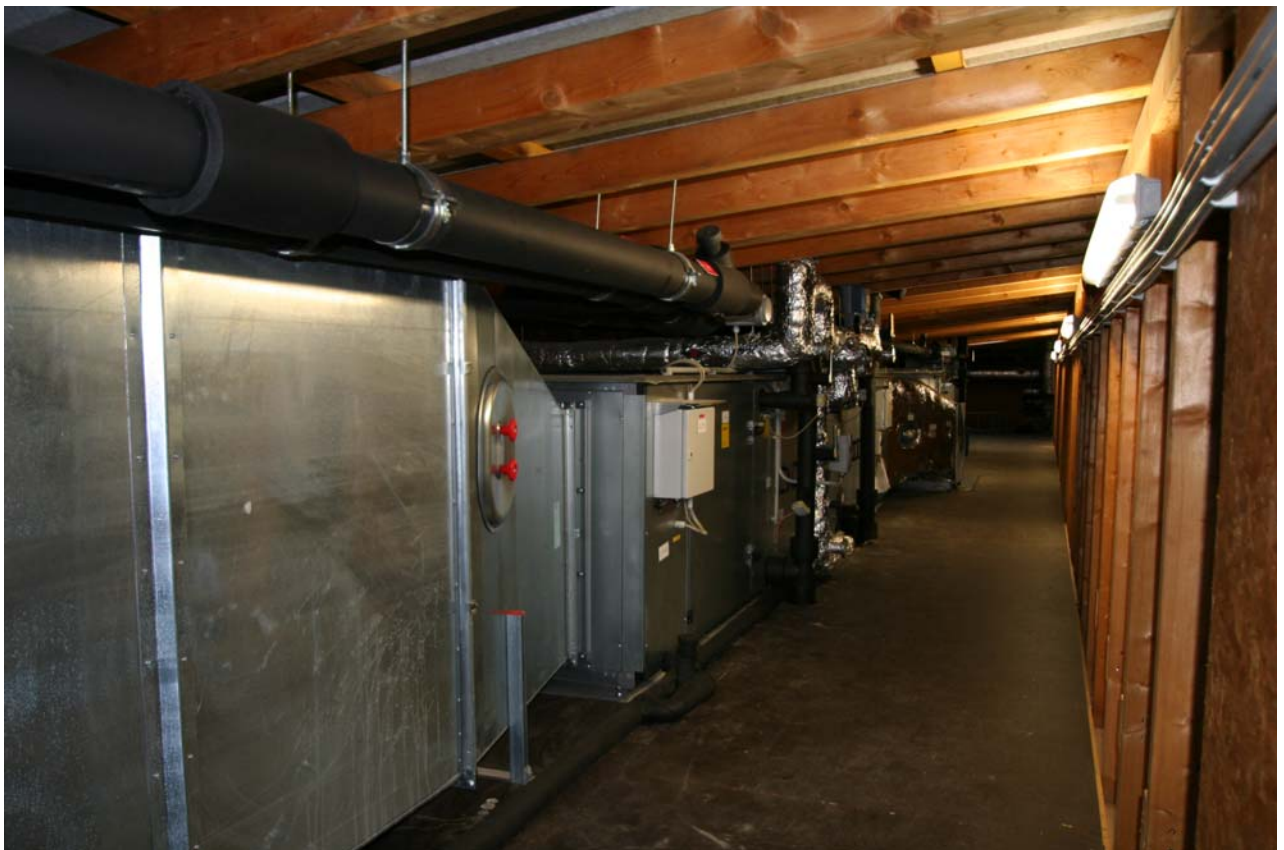
Zuluftanlage mit Aufbau Erhitzer und Kälte
