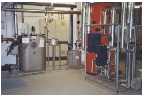
Sanitärzentrale mit Fettabscheider und WW-Aufbereitung
