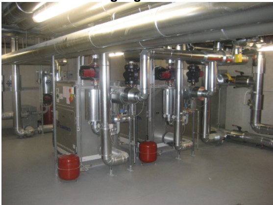
Heizzentrale UG – 2 Stück Wärmepumpen
