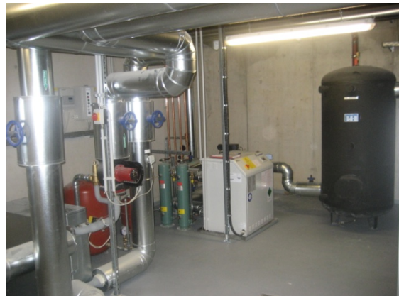
Heizzentrale UG - Kältemaschine
