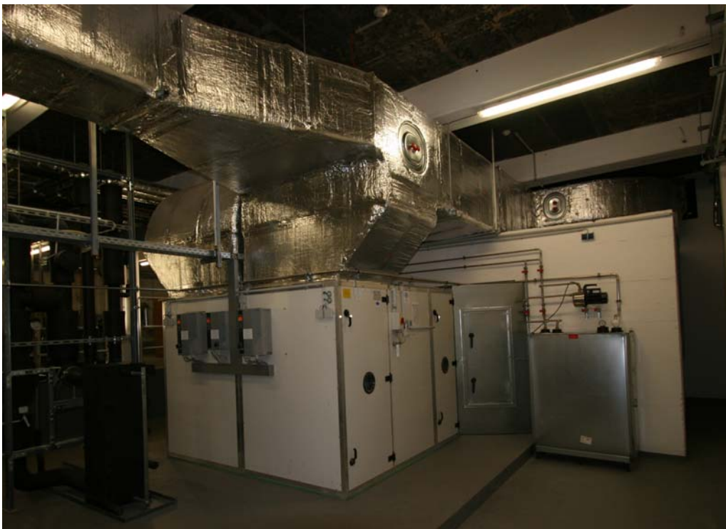
Zentrale Zuluft Hauptanlage
