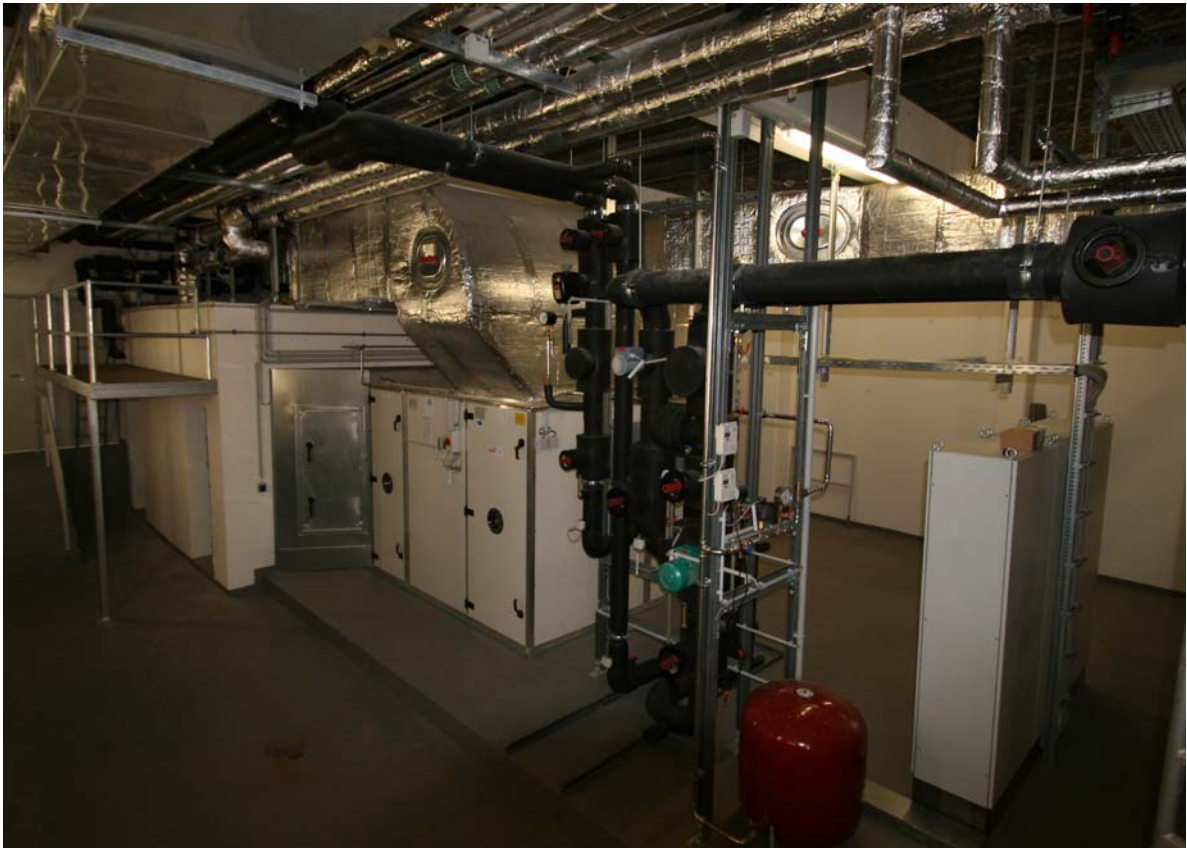
Zentrale Zuluft Hauptanlage
